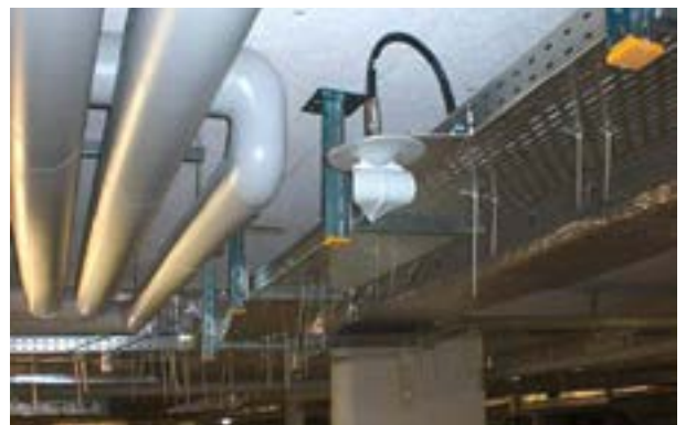
Mobile-Inhouse-Antennen gewährleisten die Versorgung in den hintersten Winkeln des Gebäudes.
